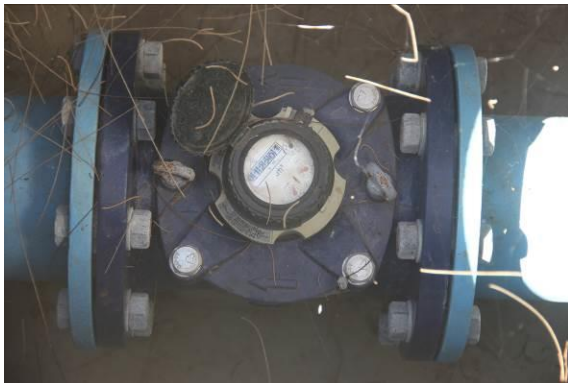
Bulk water meter at Eendekuil WTW (System Input Volume)
